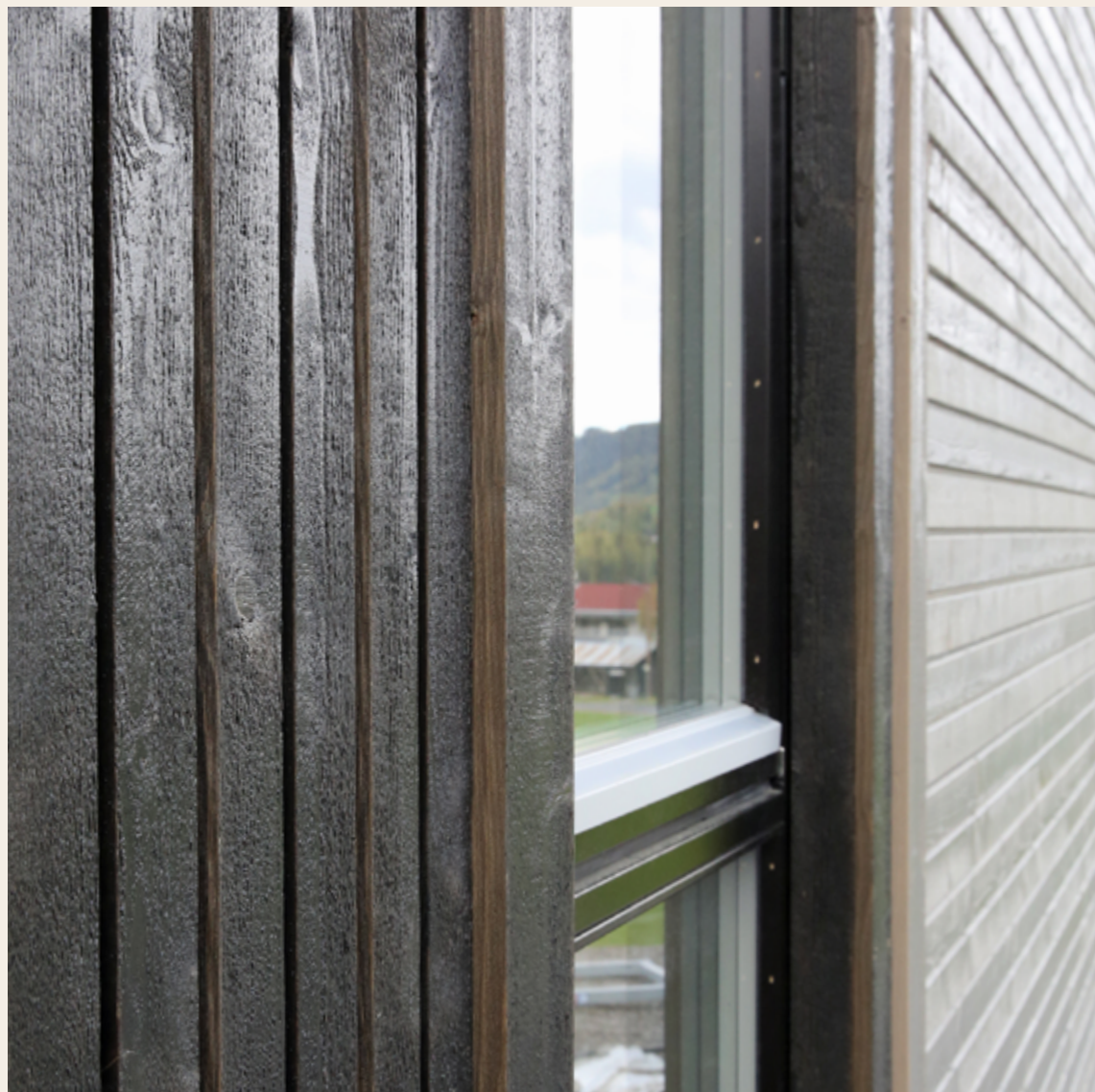
Fasade med 606 Dobbelfals 60 med spor og 638 Dobbelfals rett 10 mm med spor, montert liggende og stående. Rektangulær kledning på omramming og staffasje. Farger: TREBITT 9075 Røykgrå og TREBITT 90033 Funkissort.
