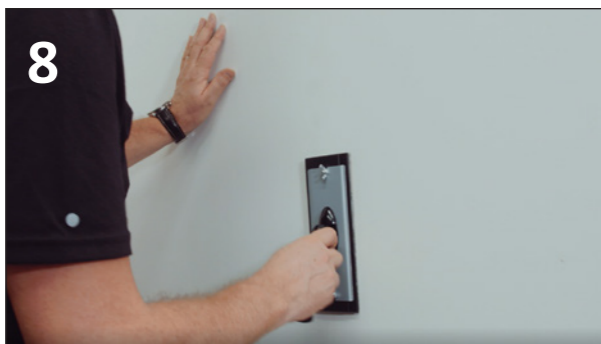
8 PUSS GJERNE LETT OVER SKJØTEN M/KORNING CA. 150.
