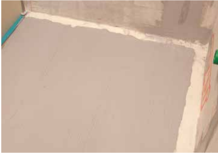
Pass på å få et jevnt lag med Hey'di K20 ut på gulvet inn mot utbretten, ikke over.
