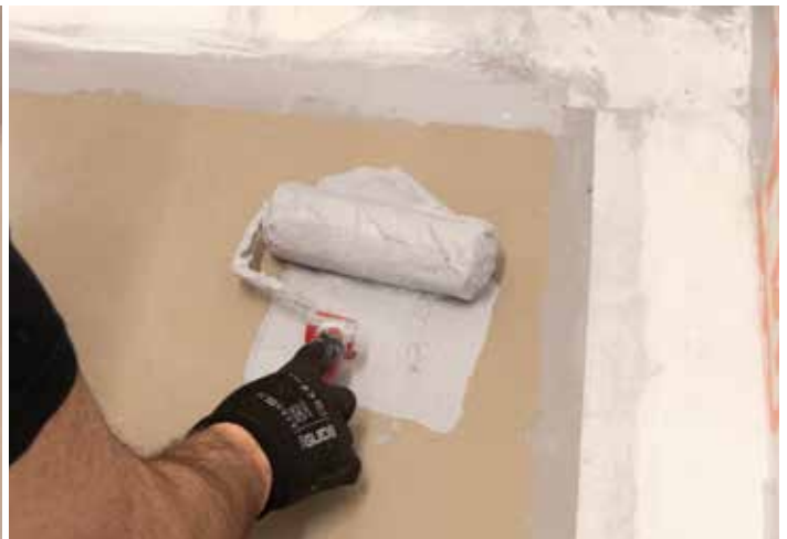
Rull deretter Hey'di K20 ut over all øvrig flate på gulvet. Forbruk ca. 0,7 kg/ kvm
