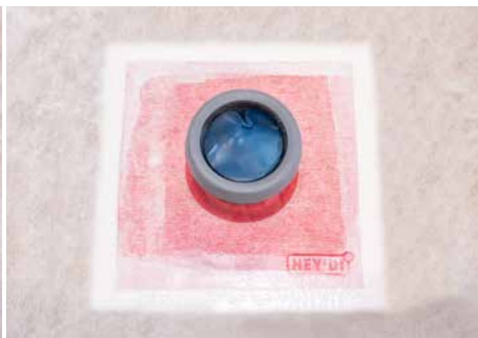
Husk det er viktig å stenge kantene på mansjetten med Hey'di Protac 25. Og slik skal en ferdig montert mansjett se ut.
